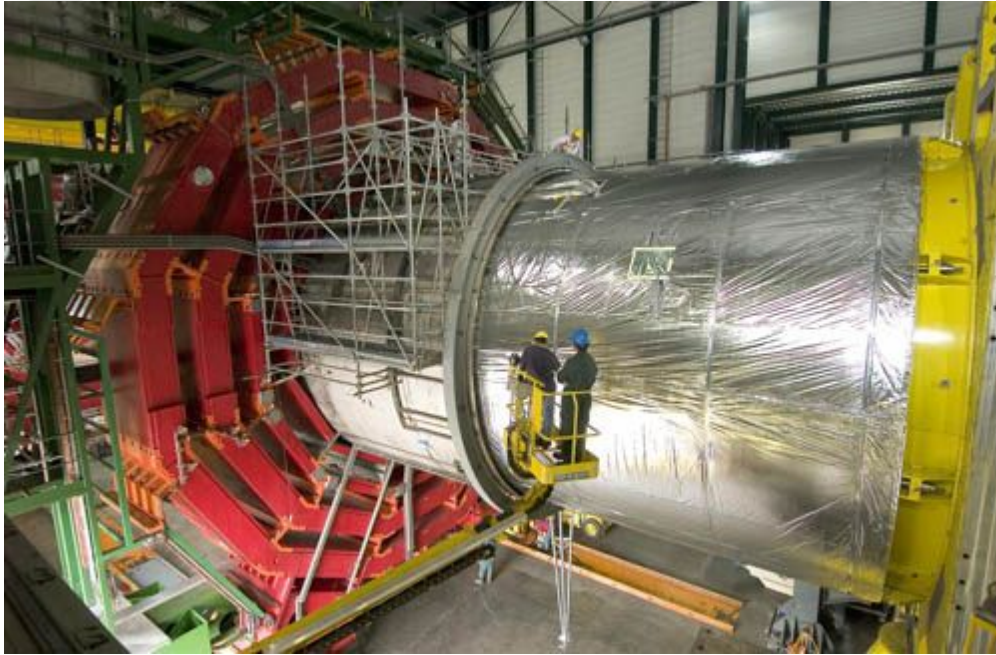
Şekil 2.10. CMS'de yer alan Süperiletken Mıknatıs ( http://cms.web.cern.ch/news/superconducting-magnet ).
