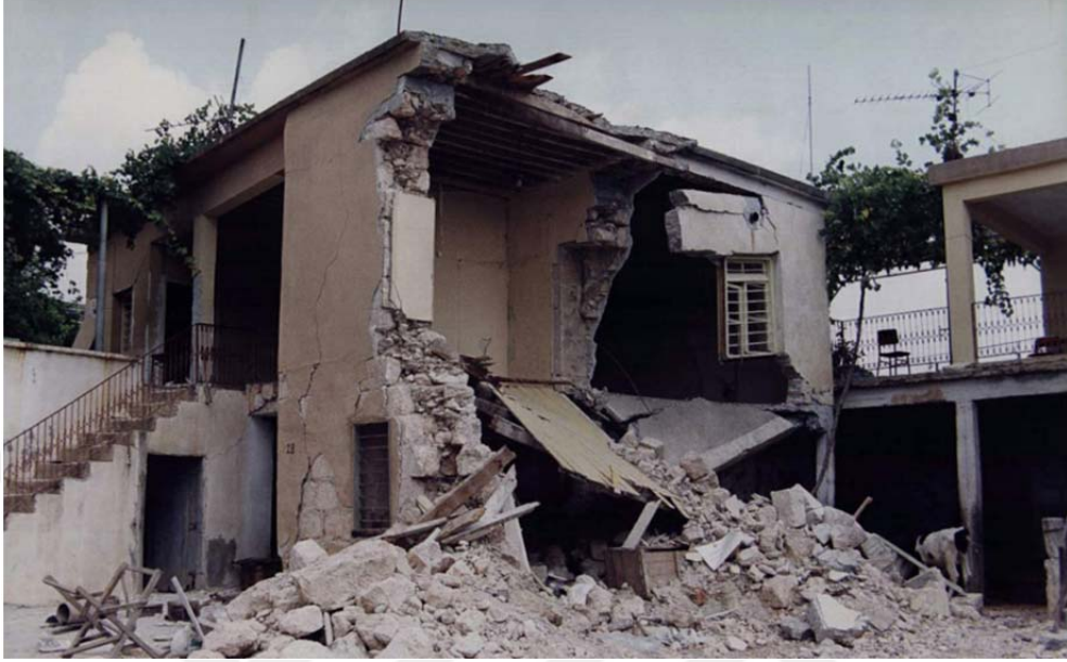
Şekil 1.1. 12 Kasım 1999 Düzce Depremi Sonrası Yapı (AFAD, 2019)
