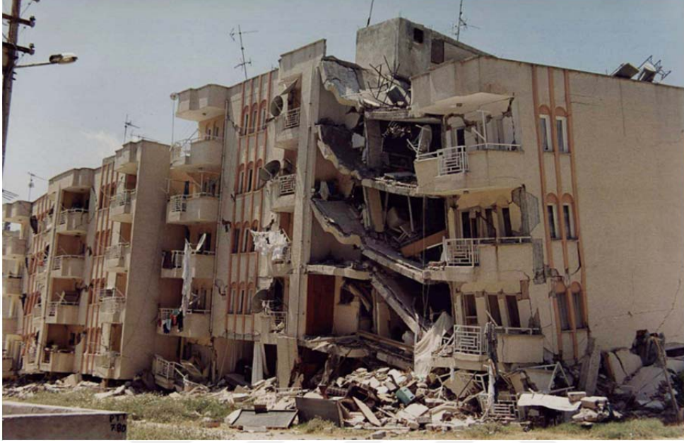
Şekil 1.4. 27 Haziran 1998 Ceyhan Depremi Sonrası Bir Yapı (AFAD, 2019)
