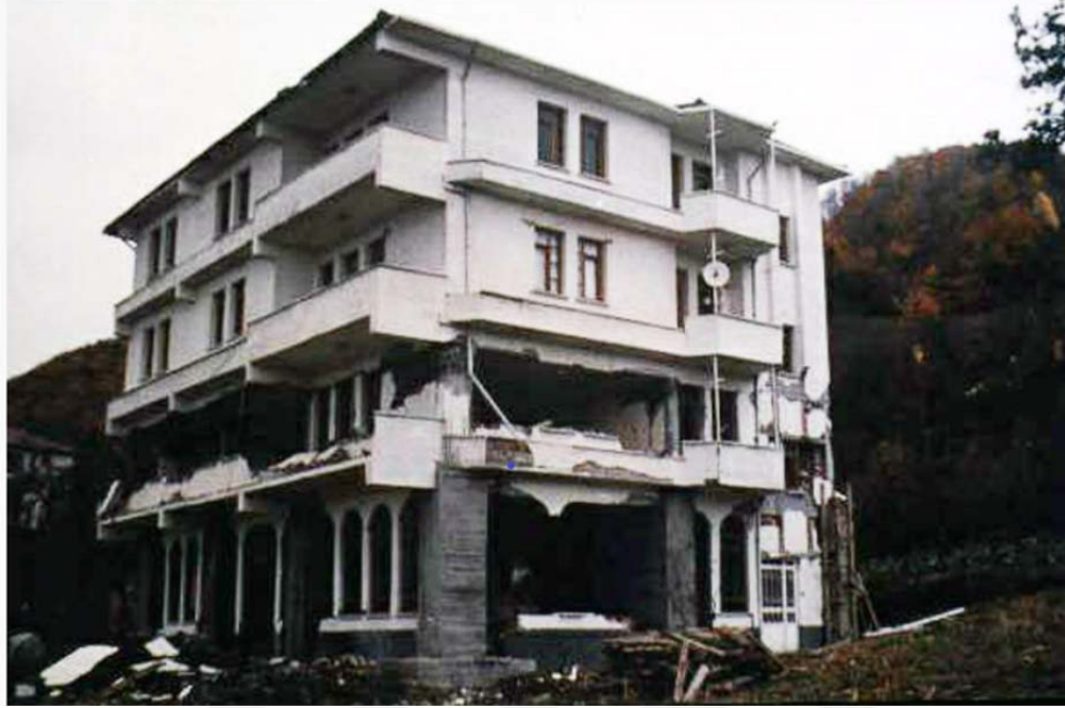
Şekil 1.3. 12 Kasım 1999 Düzce Depremi Sonrası Bir Yapı (AFAD, 2019.)
