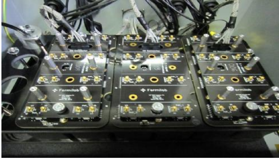
Şekil 4.11. TT'lere monte edilen yüksek voltaj kabloları
