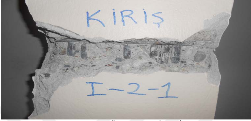
Şekil 4.25 Kiriş Alt Yüzünde Beton Örtüsü Sıyırma İşlemi İle Donatı Tespiti
